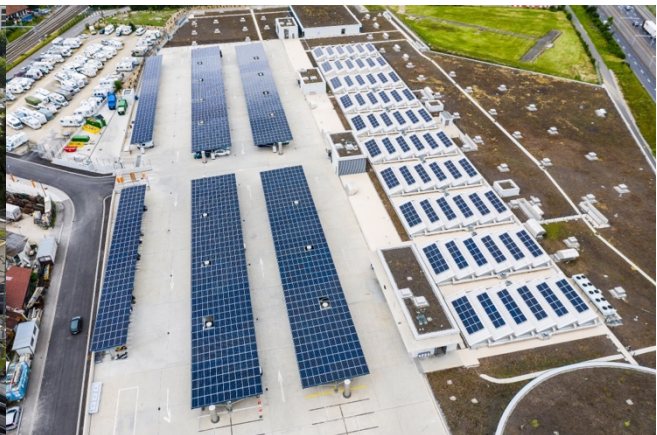
Figure 4 : En Chardon à Genève produit près de 1 GWh par an malgré sa situation difficile à proximité de l'aéroport. Photo : Prix solaire suisse 2022.
